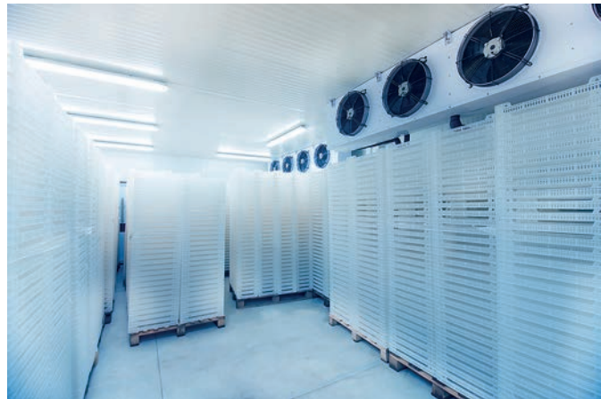
FIGURA 13 - Exemplo de câmara para refrigeração de alimentos.
