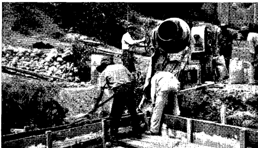
En una aldea rural de los Andes los propios habitantes preparan los cimientos para un reservorio de agua.
