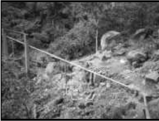
Rehabilitación del Sistema de Tetralogía afectado por el sismo del 13 de Enero 2001.
