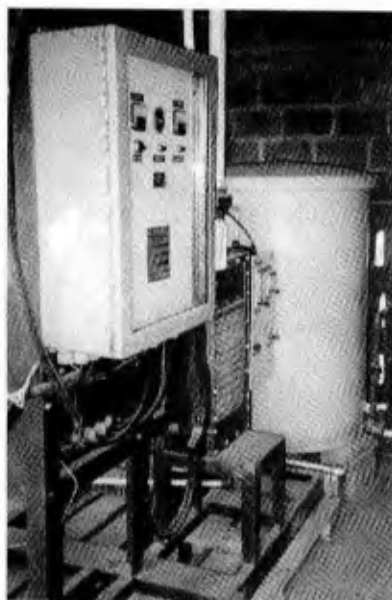
Sistema de producción in situ para una comunidad de 5.000 habitantes
