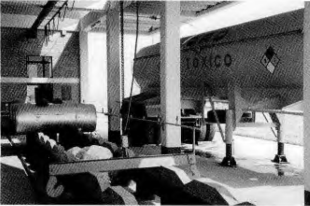
Cilindros de una tonelada y tanque rodante con cloro
