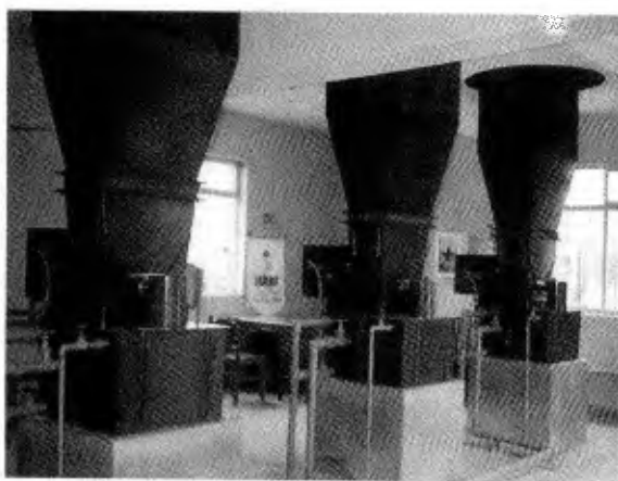
Dosificadores y tanques de disolución
