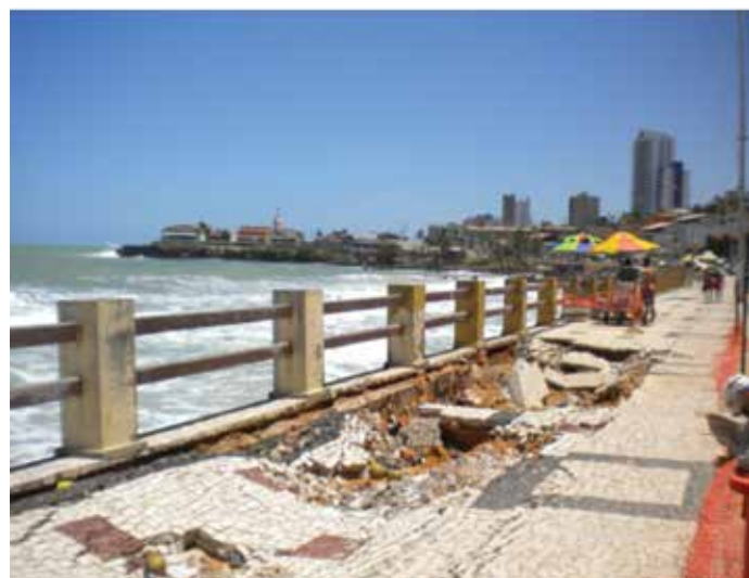
Foto 1: CARVALHO, MAUREN (Fotógrafo). Erosão Marinha em Natal no Rio Grande do Norte em outubro. 2012.
