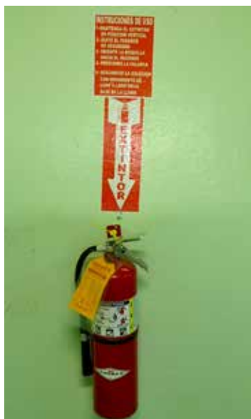
Figura 6. Extintores cargados y correctamente colocados y señalizados.
