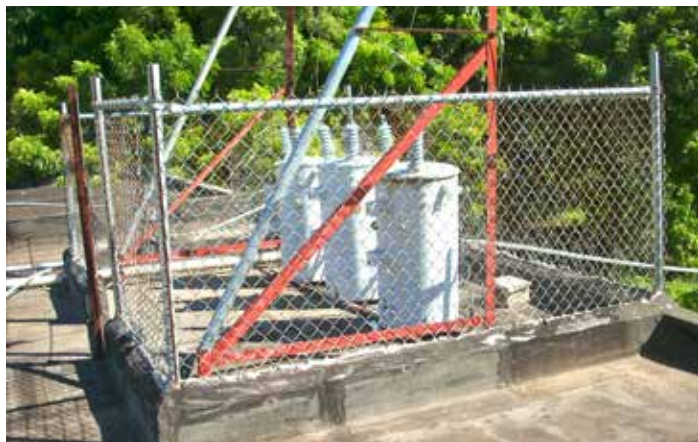
Figura 3. Transformadores correctamente protegidos.
