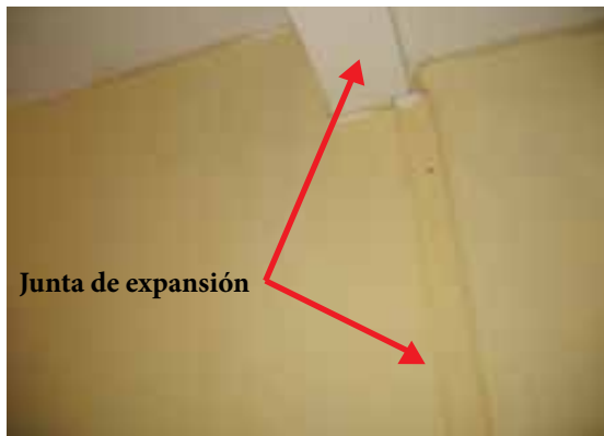
Figura 10. En esta foto se puede observar una correcta solución de la junta en pared y el techo.
