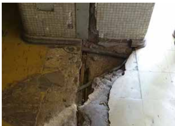
Figura 3. Juntas sísmicas selladas que no pudieron trabajar adecuadamente durante el terremoto del 2010 en un hospital de la Región VI de Chile.
