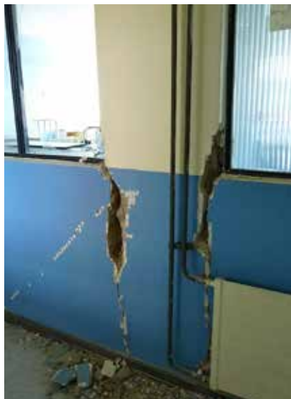
Figura 2. Columna dañada por efecto de columna corta en un hospital de la Región IX durante el terremoto del 2010 en Chile.
