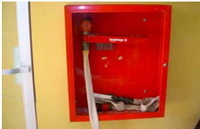
Figura 4. Gabinete para la red húmeda del sistema de protección contra incendios en mal estado técnico.
