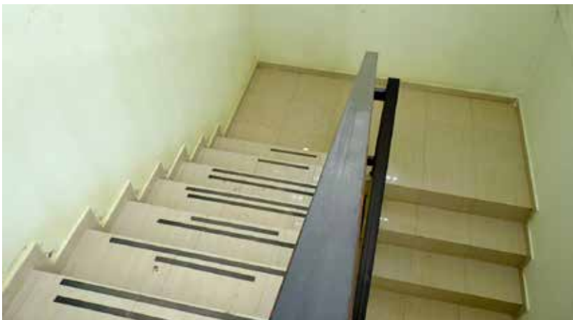
Figura 7. Una rama de la escalera correcta, la otra sin bandas antiresbalantes.
